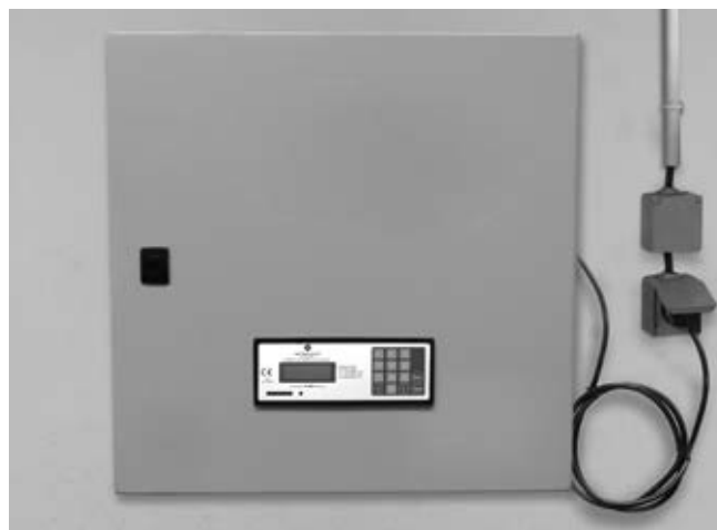
Armoire de commande intérieure métallique fermée.
