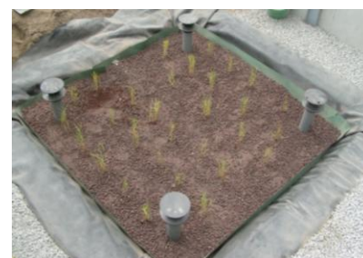
Vue du filtre lors de la mise en service
