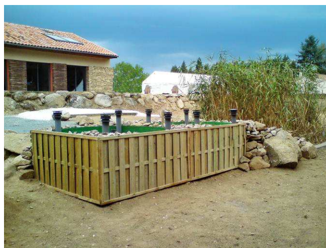
Vue des cuves Ecophyltres (implantation assimilée-enterrée)
